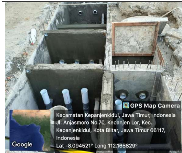
Gambar 3.3.7 Instalasi tangki septik komunal
